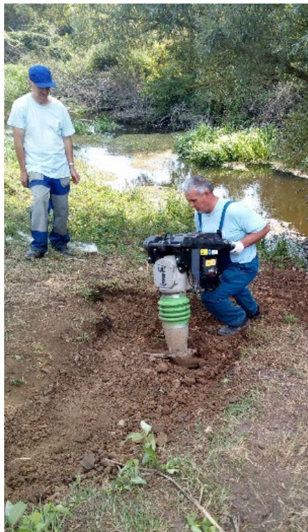
Hódok okozta kár helyreállítása
