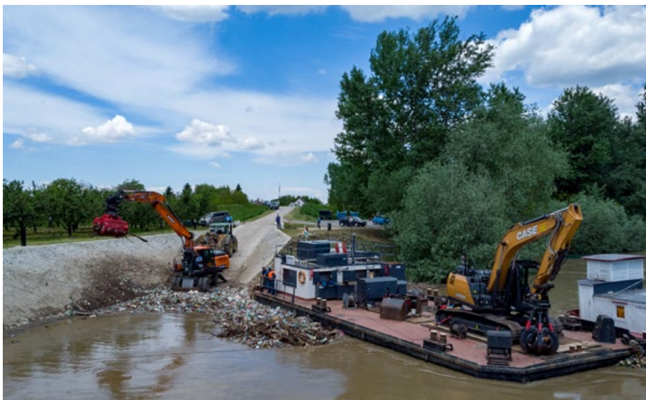
Vízminőségi kárelhárítási hely Olcsvánál (2021. 05. 21.)
