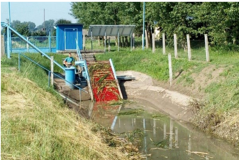
Csibaréti szivattyútelepen gazkiszedő üzemeltetése
