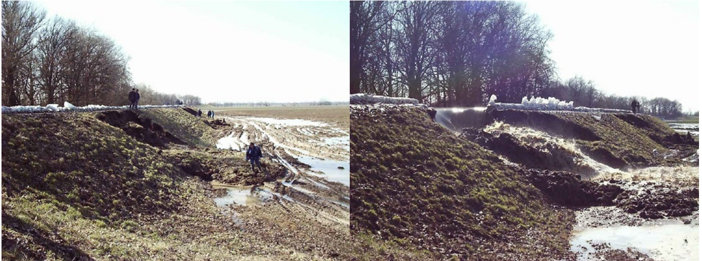
2. fénykép Suvadás, majd gátszakadás a Tisza jobbparti töltésén 2001. március 6-án
