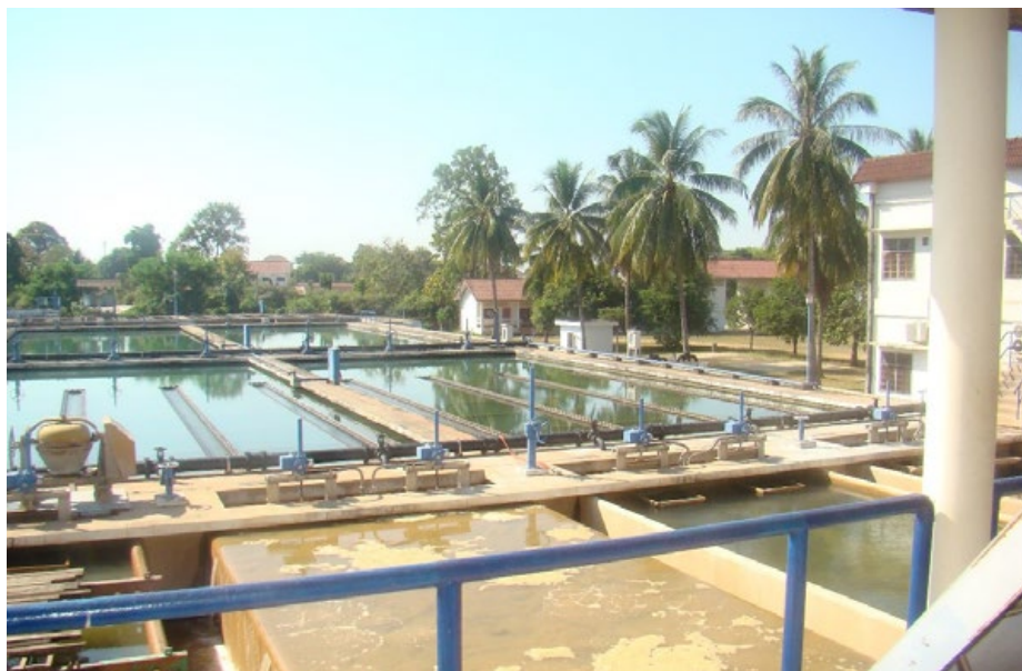
A vízmű technológiai elemei
