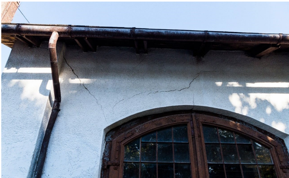
1.kép: jellegzetes károsodások a szivattyúgépház falán a felújítás előtt
