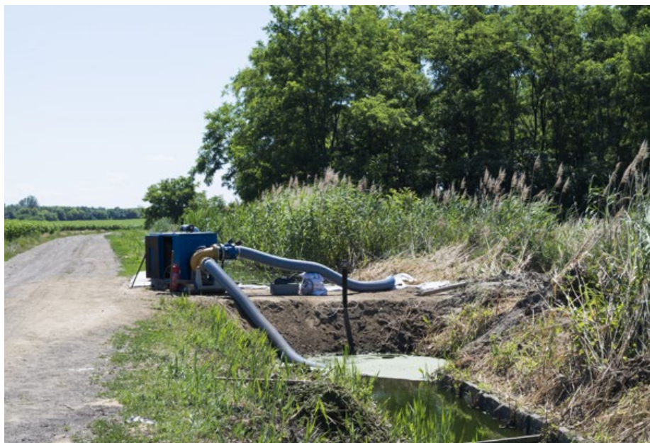
Mobil szivattyús vízáttemelési pontok a Berténytői-csatornán
