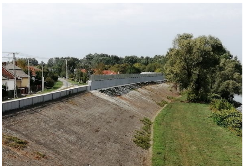
2. kép: Kiépült mobil árvízvédelmi fal és a régi parapetfal Kisar településen
