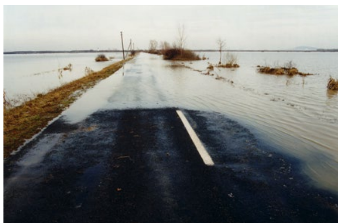
23. kép. A Tarpa felé vezető úton a közlekedés lezárva (2001. március 7.) (Fotó: Víz Zsigmond)
