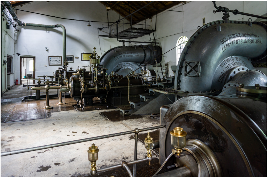
A Tiszebrceli Múemlék Szivattyútelep
